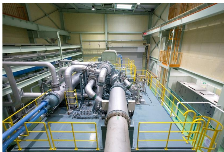
新プラント機械室内部
