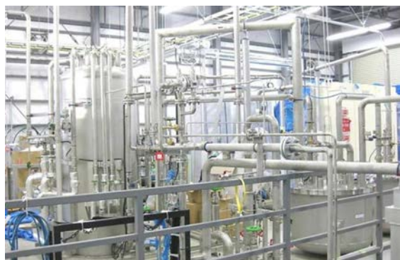
写真 1 回線 1 の LN 2 循環冷却システム中枢部
