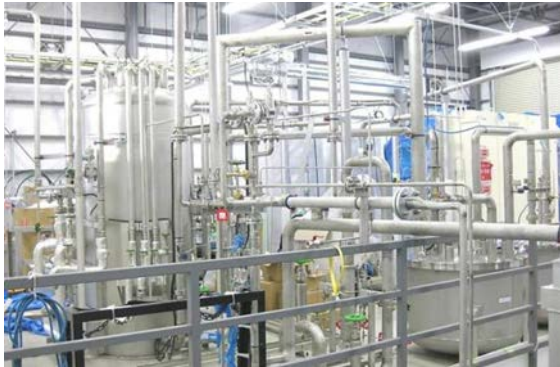
写真 1 回線 1 の LN 2 循環冷却システム中枢部
