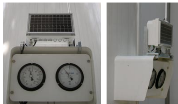
図4 THRUSH 設置写真 (残量(液面)計差圧発信機能付)
