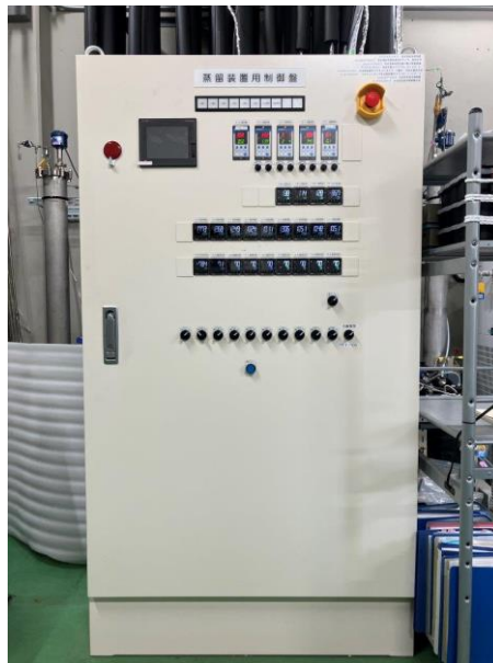
重水再濃縮装置（外観）
