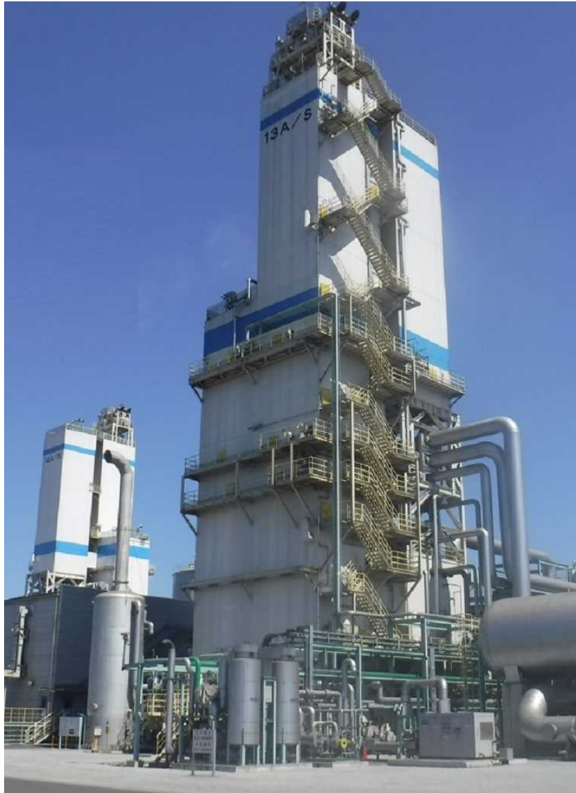
完成した13号（手前中央）、14号（左奥）空気分離装置
