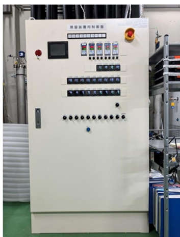
図 3 重水再濃縮装置制御盤
