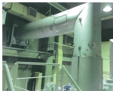
図 2 トランスファライン外観
