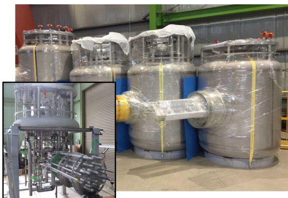
図 3 バルブボックス外観 (左下写真は内部配管)
