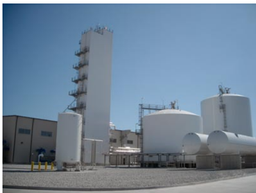
図 1 LINWELD 社 空気分離装置外観
